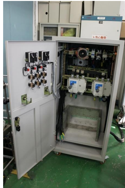
地面超级电容储能系统实验平台
