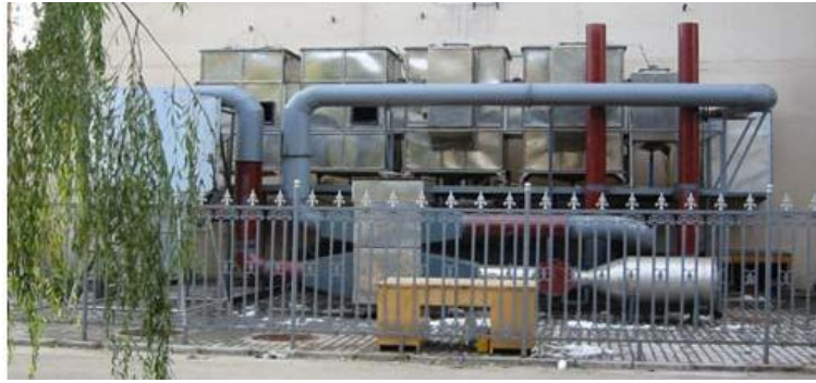
烟气脱硫半湿法试验平台
